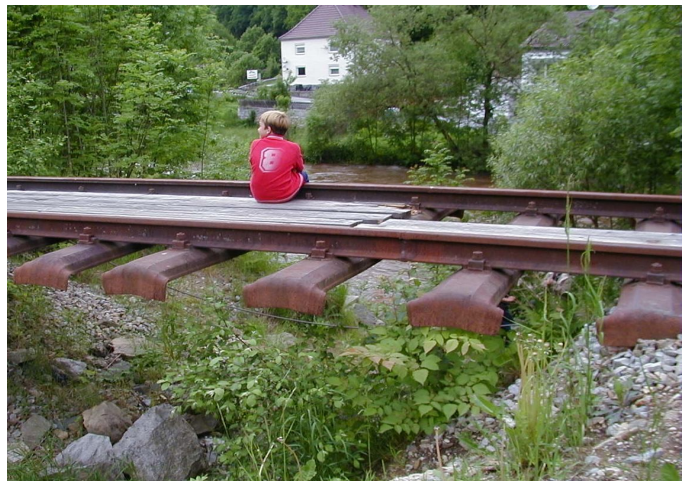
Foto 2 Unterspülte Schienen bei Voglöd.
